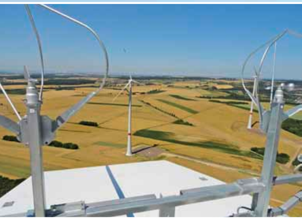
Spektakuläre Aussicht vom Maschinenhaus der Anlage 3 in Silwingen/Büdingen
